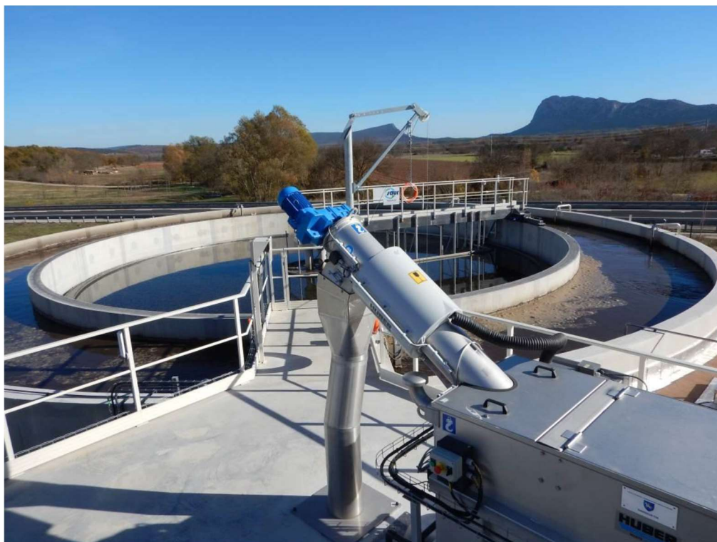
Station d'épuration des eaux usées – Saint Martin de Londres
